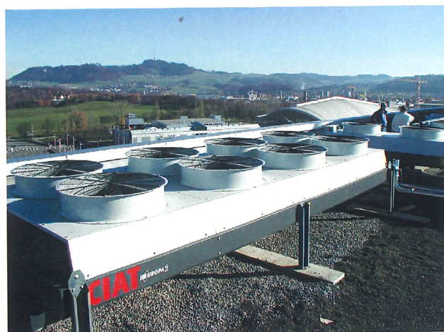
Kühlgeräte auf dem Hoteldach
