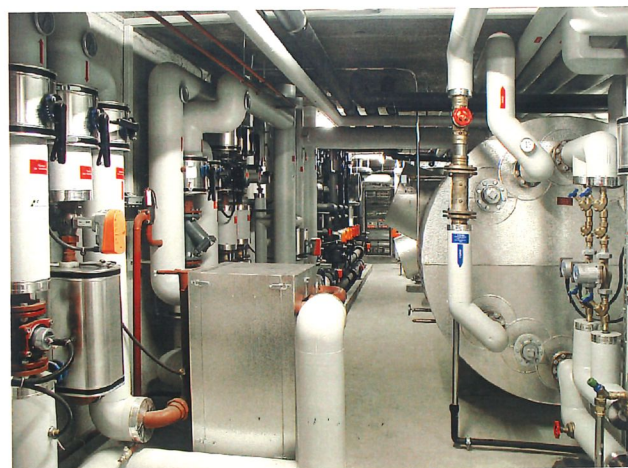
Warmwasserverteilung im Untergeschoss mit Belimo®-Stellantrieben
